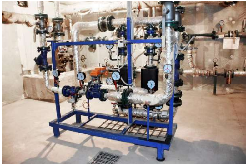
Рисунок 1 . Зовнішній вигляд ІТП в житловій будівлі
