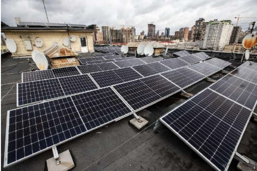
Рисунок 1 . Зовнішній вигляд встановленої СЕС на даху багатоповерхового будинку
