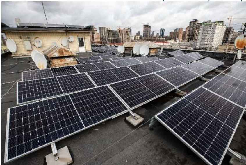
Рисунок 1 . Зовнішній вигляд встановленої СЕС на даху багатопверхового будинку
