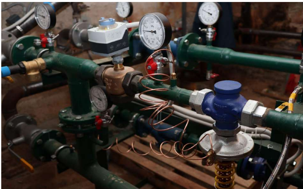
Рисунок 38 - Зовнішній вигляд обладнання ІТП
